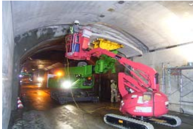
● PCL 据付状況
